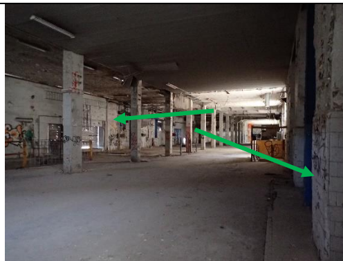
Figur 8. Prov 8. Fog kakel by 10- ej asbest enligt analys. Fix sakas sätter i bruk.
