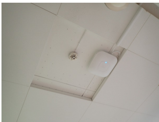
Figur 17. Kontorsdelar på plan 3, här finns eternit innehållande asbest i taket, under golven kan det finnas äldre asbestmattor.
