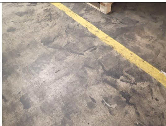
Figur 20. Prov 2, byggnad 110 grå epoxy på golv lagerhallar plan 3, ej PCB.
