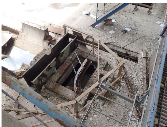
Figur 7. Löst liggande material med höga halter av tungmetaller i byggnad 13 som delvis står öppen för väder och vind. Här syns även hål ned till kraftverkstunneln. Denna byggnad har dock nu sanerats.
