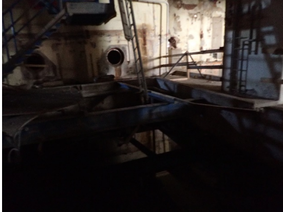
Figur 12. Vatten i kassun på bottenvåning byggnad 10 bedöms vara regnvatten.
