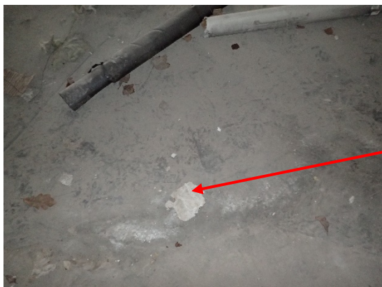
Figur 20. Synlig asbestisolering på golv från att nedriva värmerör nedre plan by 18.
