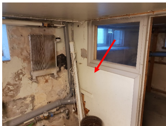
Figur 29. Tjärade ytterväggar, innerväggar av eternit och rör med asbestisolering är exempel på byggmaterial som klassas som farliga avfall om de rivs ut.
