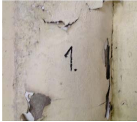
Figur 17. Foto från by 10, väggfärgen innehåller PCB (21 mg/kg).
