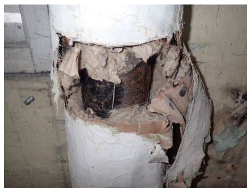
Figur 19. Ren asbest i isolering kring värmerör på både raksträckor och i böjar.
