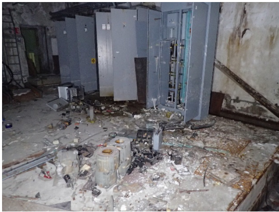
Figur 8. Mindre oljefläckar i vandaliserat f d trafo/ställverksrum, troligtvis kommer oljefläckarna från f d trafo, kabel och oljebrytare.
