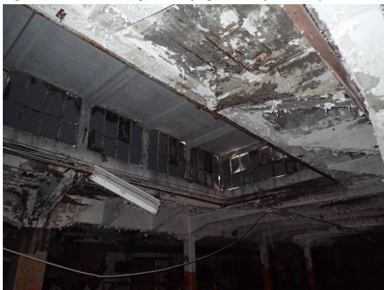
Figur 26. Betydande fuktskador med frost-sprängningar och synligarostiga armeringsjärn finns i många byggnader.
