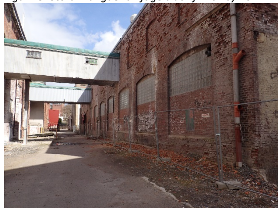
Figur 27. Betydande fuktskador med frostsprängningar i tegelfasader.
