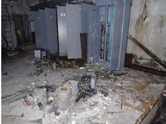
Figur 16. Foto från f d trafo/ställverksrum. Oljespill från nedrivna brytare, trafo och kablar kan innehålla PCB.
