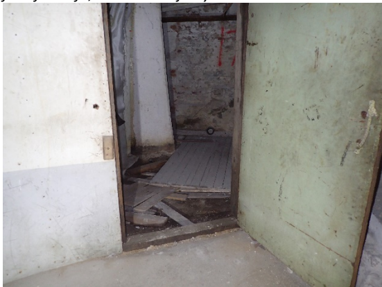
Figur 10. Källarutrymme under by 17 här finns ett utrymme som luktar diesel.
