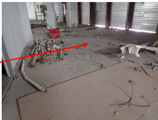
Figur 21. Synlig asbestisolering på golv från att nedriva värmerör nedre plan by 18.
