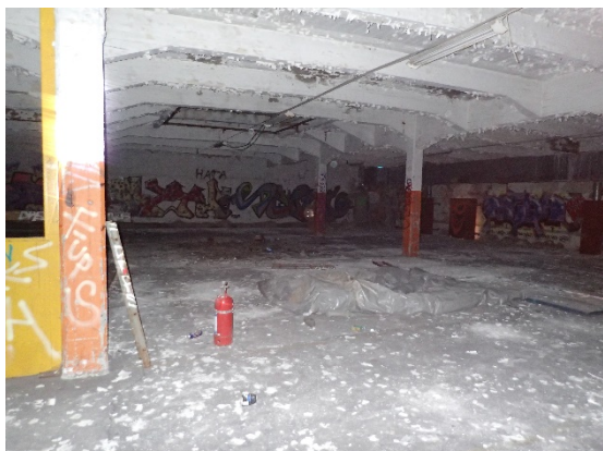
Figur 2. I många byggnader är golven täckta med löst material som utgörs av färg, puts, damm mm med höga halter av tungmetaller.
