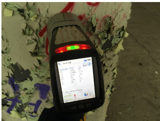
Figur 3. Måttligt förhöjda halter över MKM till höga halter över FA av tungmetallerna bl.a zink, bly, koppar, krom förekommer frekvent både på betonggolv och betongväggar i samtliga byggnader enligt de XRF mätningar som utförts mot ytskikt
