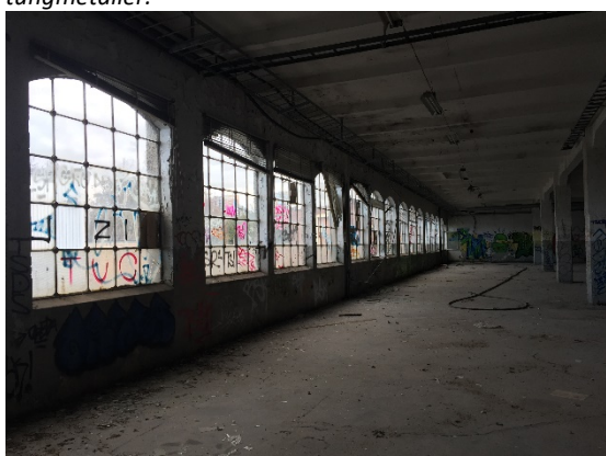
Figur 6. Äldre stålstomme och stålfönster är målad med en färg som innehåller höga halter av bl. a bly.
