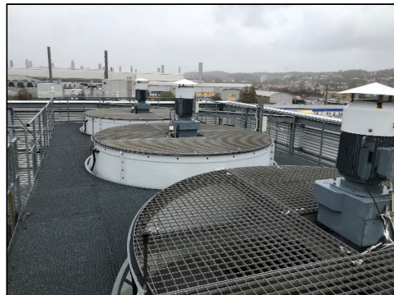
Figur 4, Kyltornets tre utblås. I bakgrunden syns hus MD vid de två höga skorstenarna.
