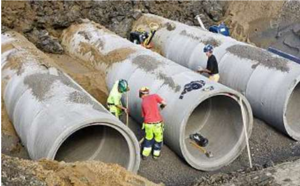
Figur 24. Underjordiska rörmagasin för fördröjning av dagvatten. (St: Eriks, 2015)
